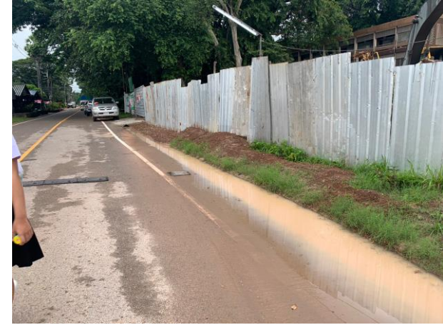
พบน้ำขังจุดก่อสร้างอาคาร 6
